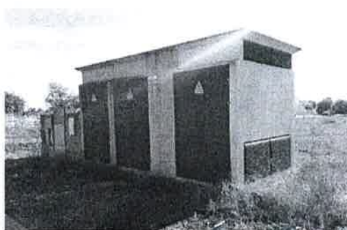
Monolito, y centro de transformación existentes en el interior de la Manzana 13.4, en la avenida Ecos del Rocío, en el tramo próximo a la avenida de la Democracia.
